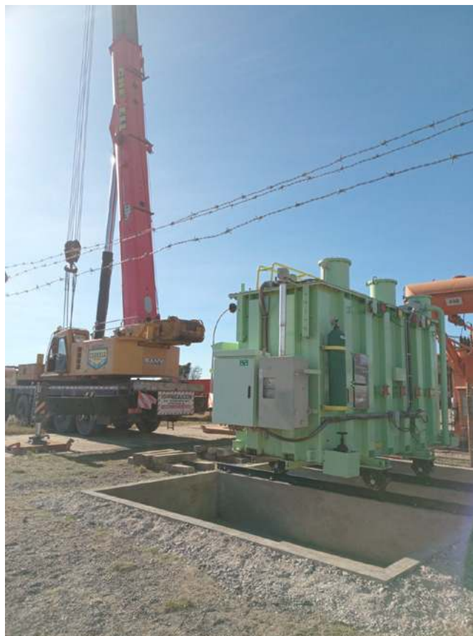
Ubicación del nuevo transformador en la estación de Río Colorado. La obra permitirá mejorar la calidad del servicio eléctrico ante el aumento sostenido de la demanda.
